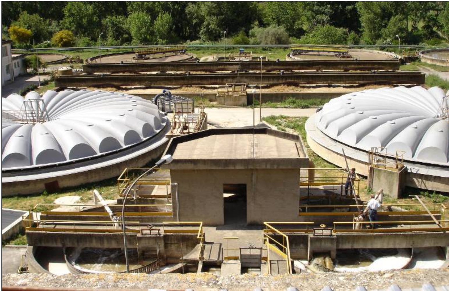
Vista dell'impianto di depurazione di Ragusa (contrada Lusìa)
